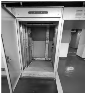
图2 现场空柜 Fig. 2 Empty cabinet on site
