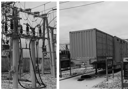
图 15 融冰装置通过电缆与线路连接
