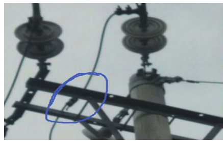
图9 现场弧光接地故障点
