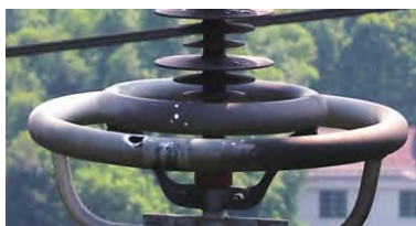
图7 均压环上的闪络痕迹
