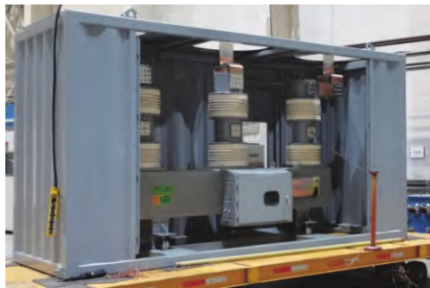
图5 抽水蓄能机组电气制动开关
