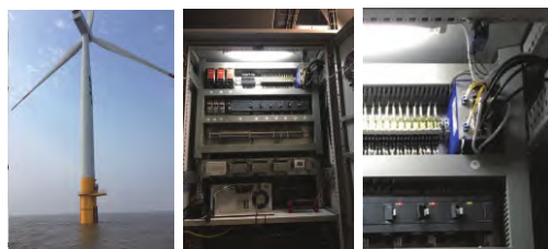
图6 塔基控制柜内的工业交换机安装图
