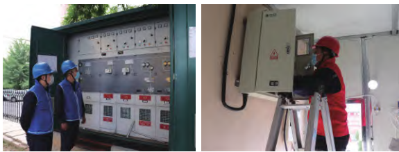
图5 配电作业人员依据物联网设备反馈信息进行定点巡检
