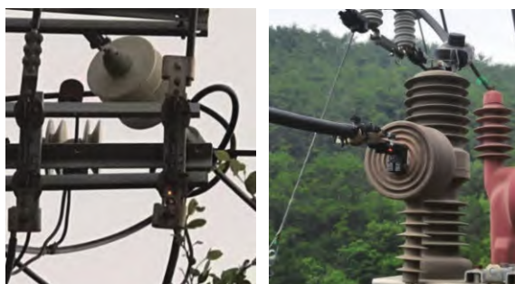
图4 发热烧损的C形线夹（安普线夹）
