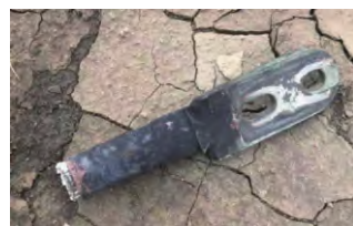
图6 发热烧损的鼻子
