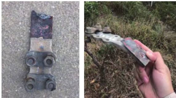
图2 发热烧损的铜铝过渡设备线夹
