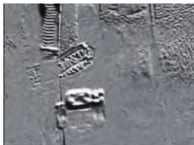
图6 堵漏后SF 6 红外成像仪检测图
