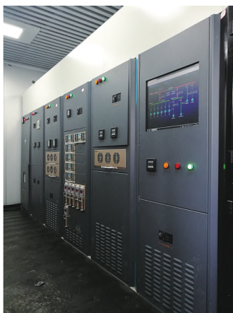
图4 多站合一智慧能源舱内景图
