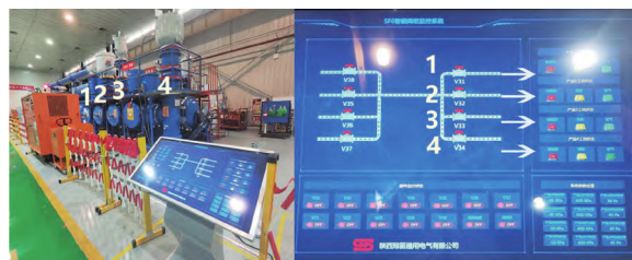
图3 PT产线实验台配套的SF 6 智能阀组监控系统
