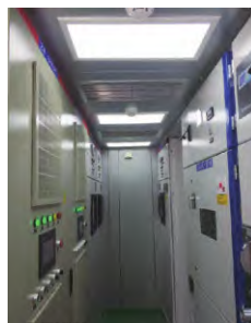
图3 系统舱内实景
