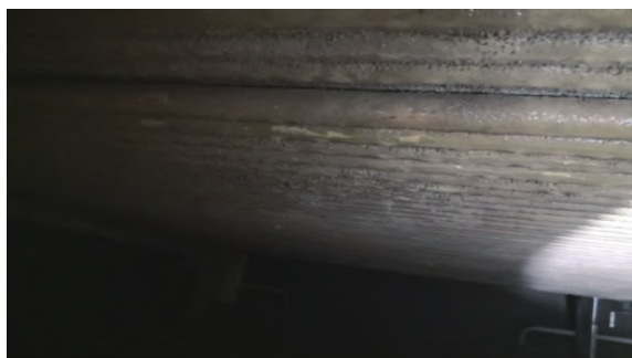
(a) 蒸发器内部换热管结垢情况
