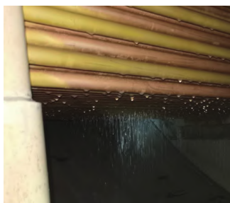
图3 某电厂04海水淡化装置蒸发器化学清洗效果直观检查
