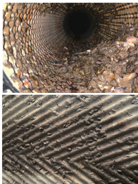
图3 某电厂04海水淡化装置系统内板式换热器污堵情况
