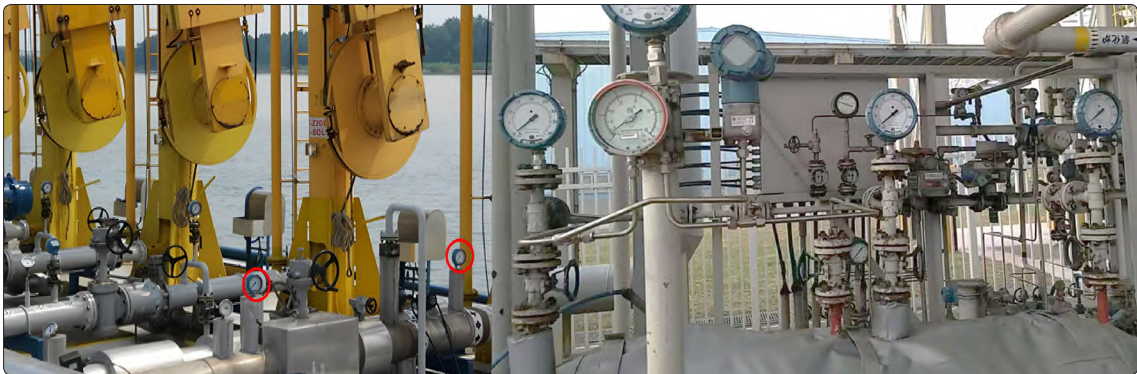
图 2 艾默生 WPG 无线压力表在码头和焚烧炉的应用
