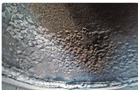
图1 弯头内壁腐蚀情况
