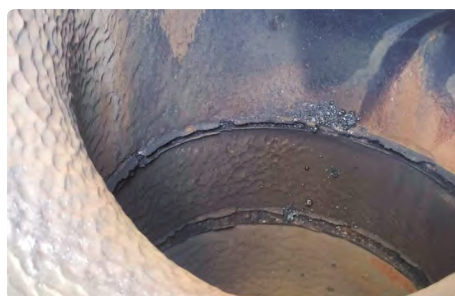
图2 焊口内壁腐蚀情况
