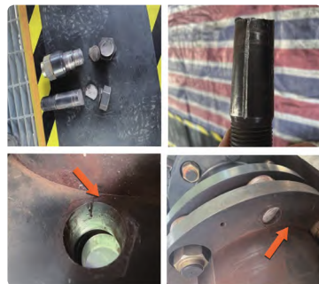
图 3 联轴器螺栓断裂及磨损情况
