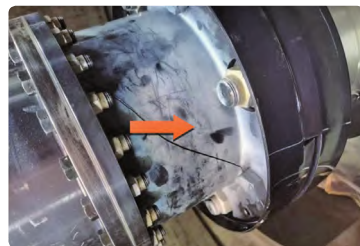
图 6 联轴器中间隔套贯穿性裂纹
