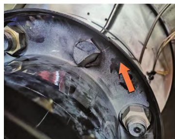
图 7 螺栓背帽发生断裂
