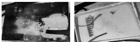
图5 消谐装置开箱检查
