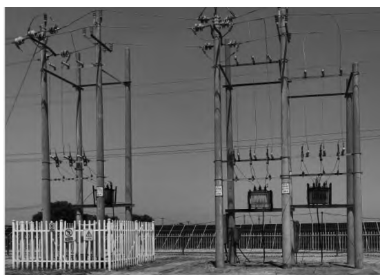
(a) 井场改造前多台变压器
