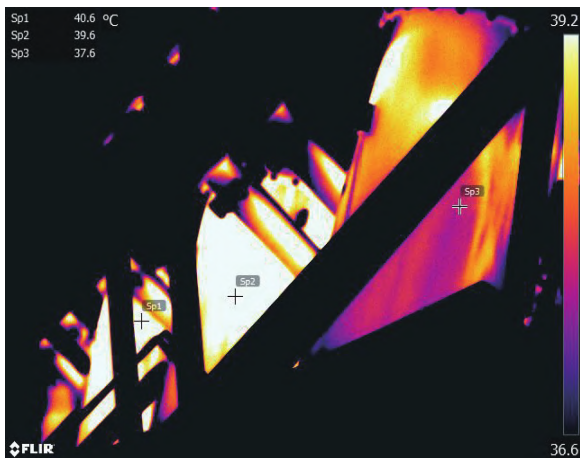
图2 某220 kV主变压器高压侧升高座红外图谱
