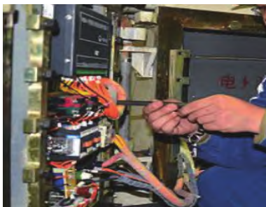
图3 内部开箱检测
