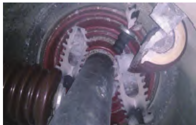
图4 封闭母线支撑绝缘子损坏
