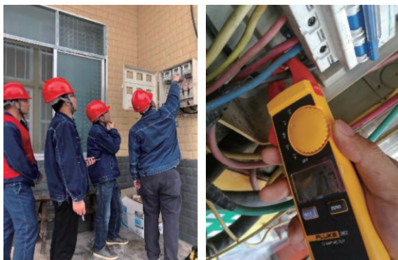
图2 供电公司开展现场电表检测工作
