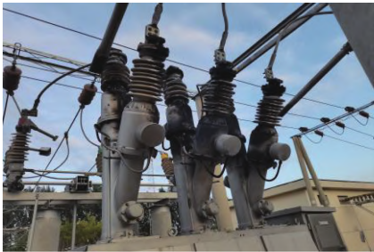
图2 变电站345断路器烧毁情况
