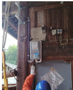
图8 木质房屋低压供电侧现场图
