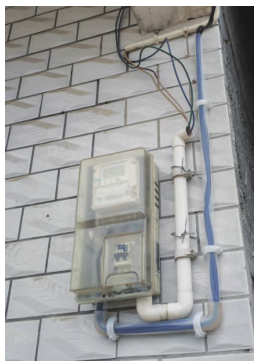
图7 水泥砖房低压供电侧现场图
