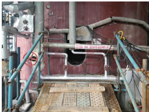
图1 吸收塔设备现场状态
