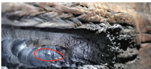
a) 焊接裂纹
