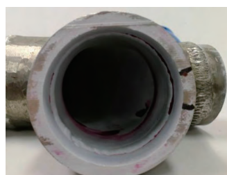
图5 M6缝PT检测显示照片
