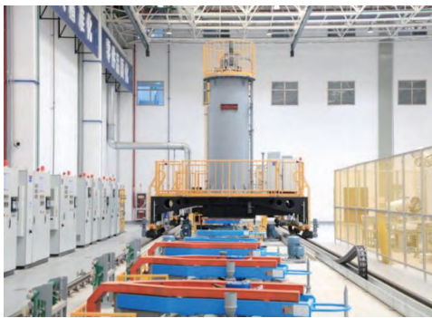
图1 机架热处理生产线
