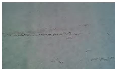
图2 板材表面横裂纹
