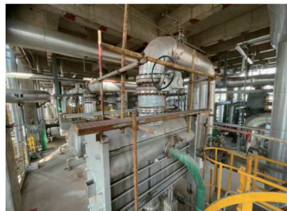
砂眼具体漏点 E4104 (循环氢化液冷却器) 上部
