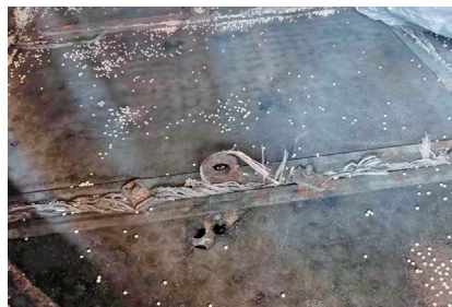
图 1 蒸煮处理后丝网的腐蚀情况
