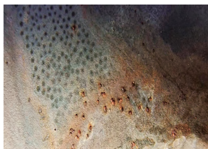
图 3 蒸煮处理后塔壁形成的点蚀
