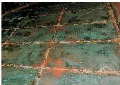
图 4 直接蒸煮处理后腐蚀情况
