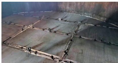
图 5 优化方案处理后腐蚀情况
