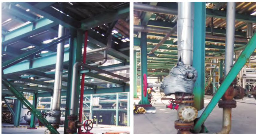
图3 现场解析气管线配管
