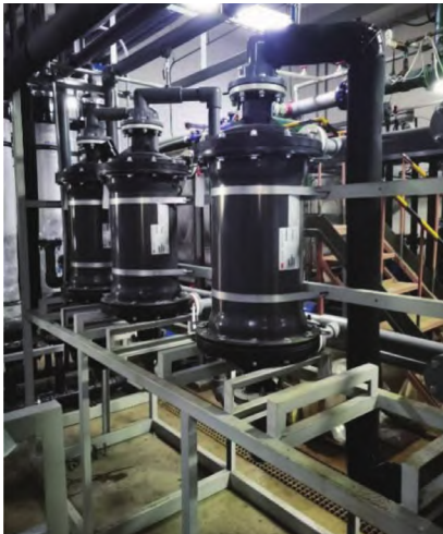
图 14 TMCS 系统现场
