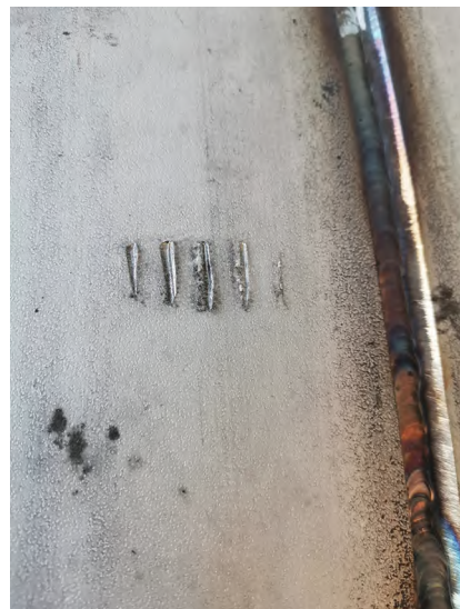
图 5 吊具造成的严重损伤
