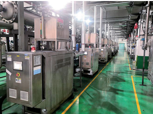
图 2 导热油加热锅炉
