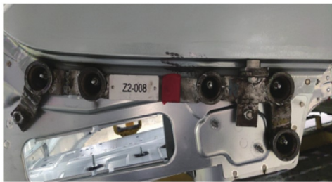
图1 线下焊钉位置目视检查
