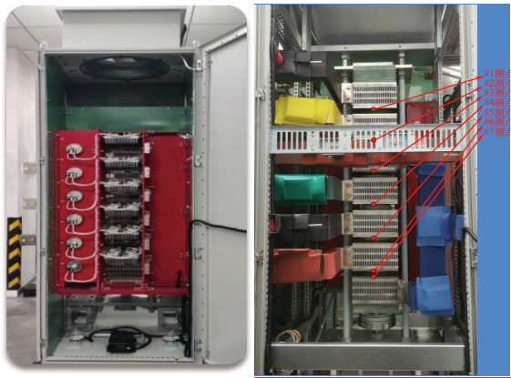
图 6 直流 4 000 A 级风冷型 SFC 功率屏柜 Fig. 6 DC 4 000 A air-cooled SFC power cabinet
