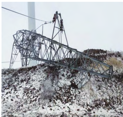
图2 因覆冰导致的杆塔坍塌
