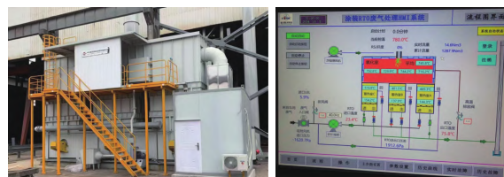
图6 蓄热式热力氧化设备 (RTO) 废气治理示范应用项目现场运行图
