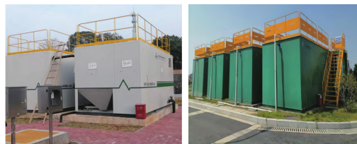
图8 移动床生物膜反应器（MBBR）一体化设备项目现场运行图
