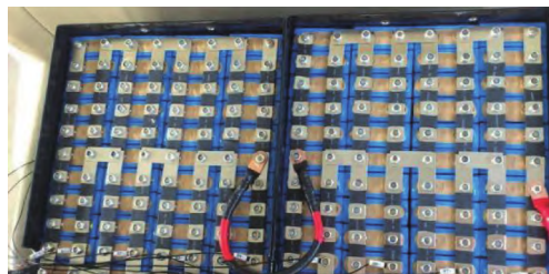
图1 模拟实验磷酸铁锂电池组实物
