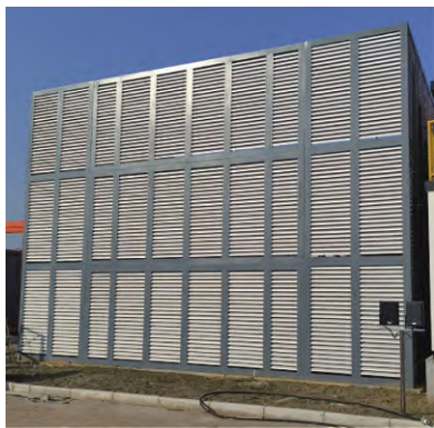
图3 主变压器Box-in隔声罩
