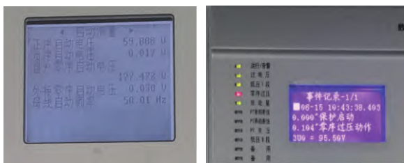
(a) 进线柜综保
