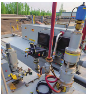
图1 特高压直流换流阀厅用套管运行状态监测现场
