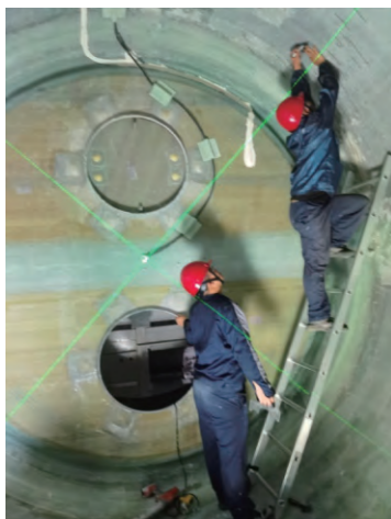
图2 光纤传感器安装现场
