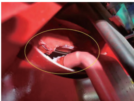
图6 低压引出线铜排与低压绕组本体拉裂
