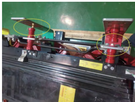
图5 固定低压引出线铜排的绝缘子断裂
