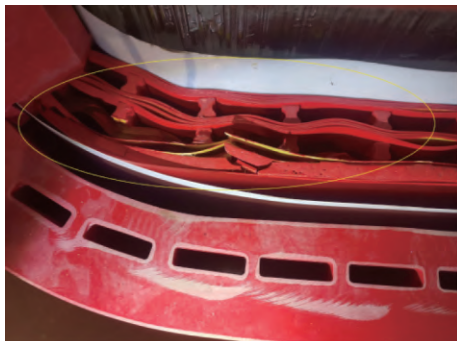
图3 低压绕组变形和开裂
