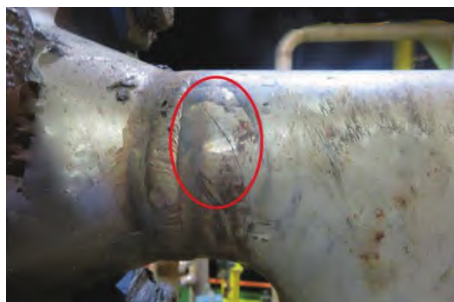
图1 双相不锈钢焊接接头泄漏位置
