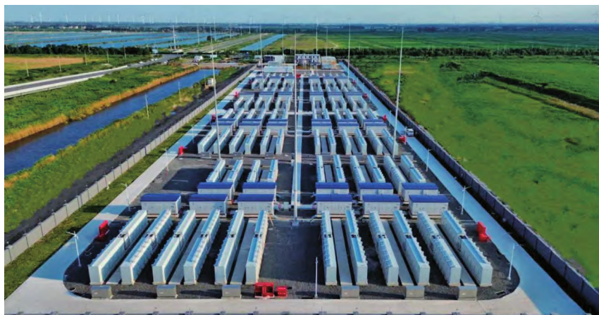
领储宇能滨海200 MW/400 MW·h共享储能电站项目
