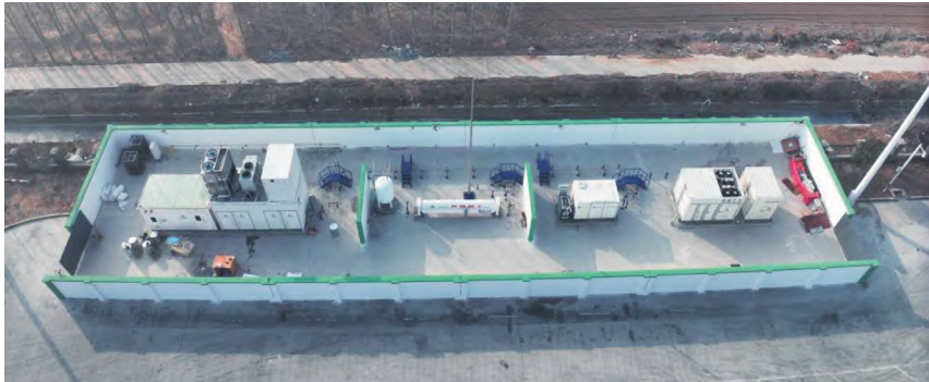
全国首个高速公路服务区现场制氢、储氢、热电联供项目
