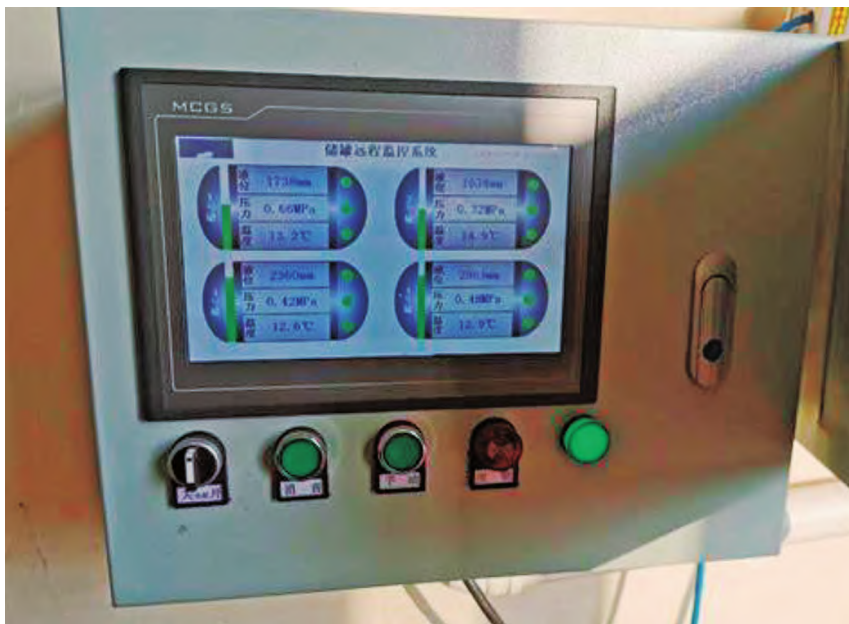
图3 石油液化气储罐远程报警系统
