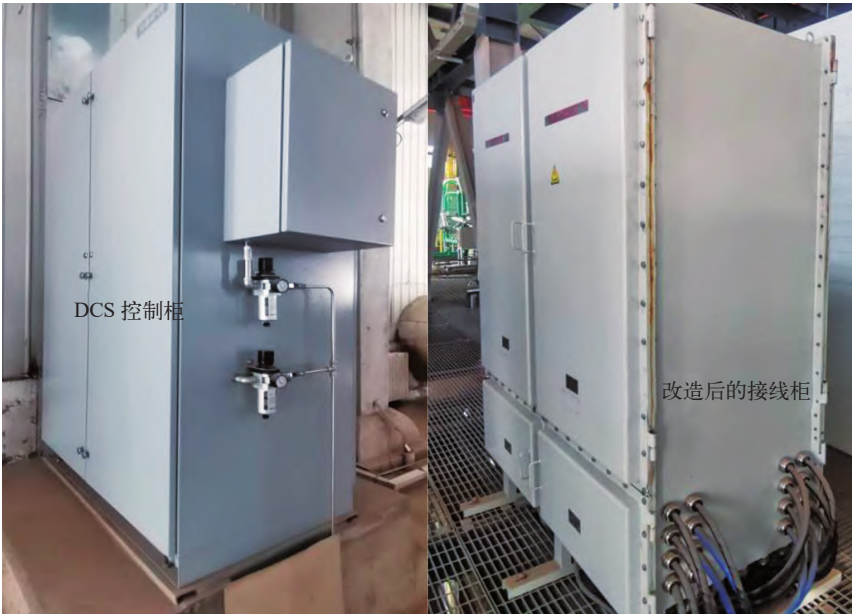
图 4 新增 DCS 远程控制柜及改造后的接线柜
